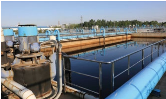
Planta potabilizadora, última barrera para garantizar la calidad del agua
